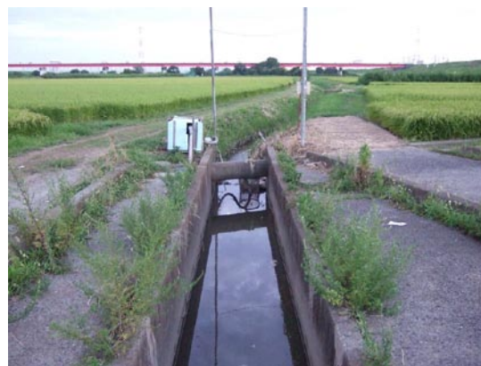
排水路とポンプ
